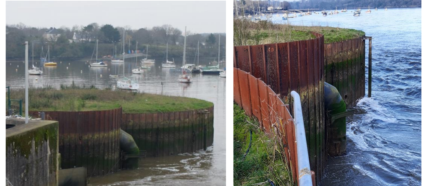
Figure 8 : Gabions dégradés, en aval du barrage
