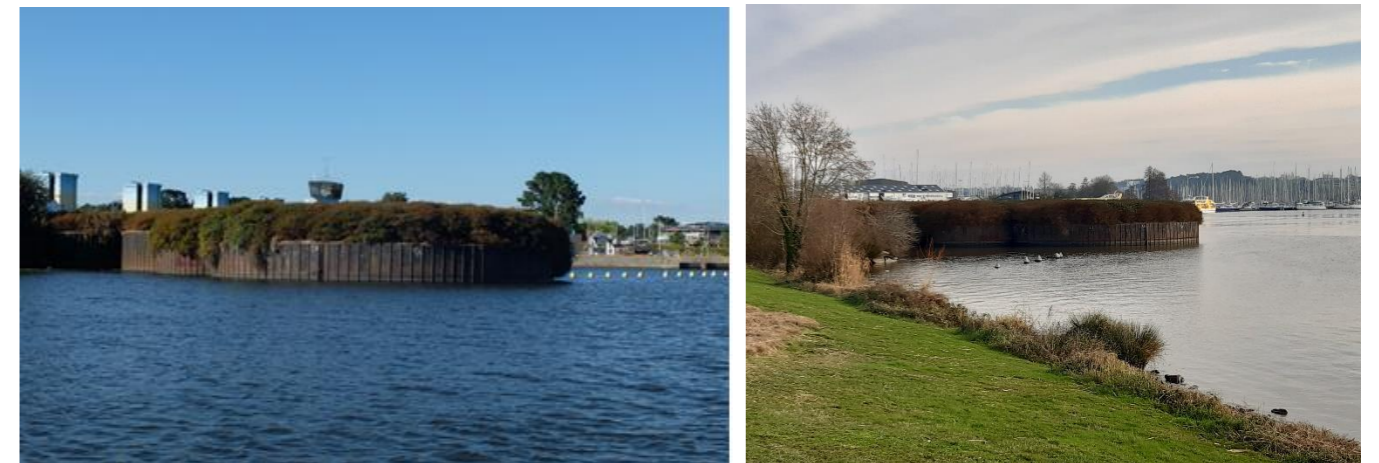
Figure 9 : Gabions dégradés, en amont du barrage
